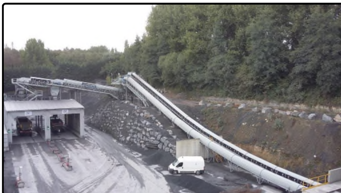
Vue des convoyeurs alimentés par les silos de stockage en direction de la nouvelle zone de chargement couverte
